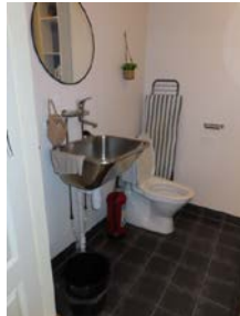
Vaskerom/toalettrom, kombinert rom med tekniske installasjoner.
