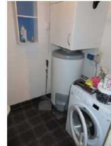
Vanninntak, varmtvannsbereider samt vann og avløpsuttak for vaskemaskin.
