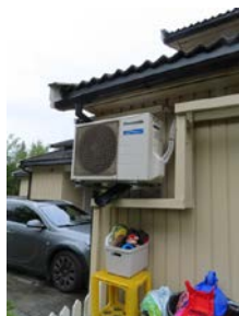
Luft til luft varmepumpe fra byggeår.
