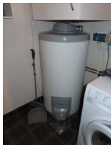
200 liters varmtvannsbereder inne på vaskerommet.
