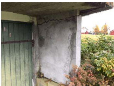
Sprekkdannelse i grunnmur som understøtter støpt, utkraget dekke.
