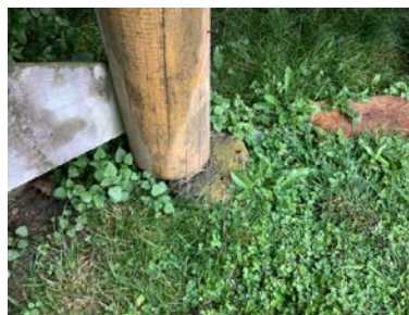
Skjev trestolpe er i ferd med å gli av fundament.
