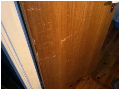
Eksempel på slitasje på dør.
