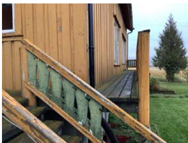
Deler av terrassen mangler rekkverk.
