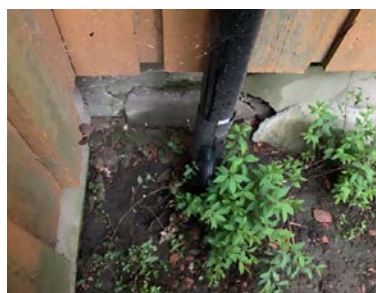
Mangelfull bortledning av takvann.
