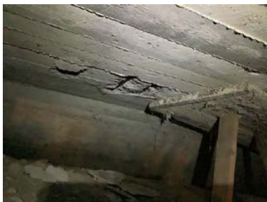
Skade i støpt dekke og eksponert armering.
