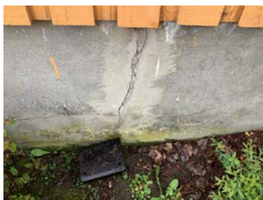
Sprekkdannelse i grunnmur.
