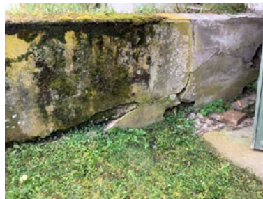
Sprekkdannelse i mur.
