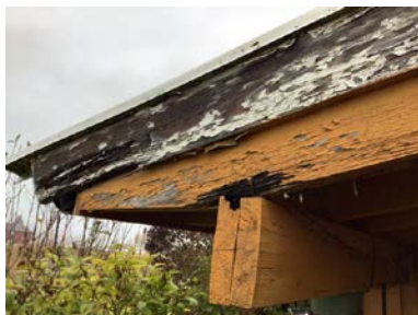
Råteskadet taksperre og vindski.
