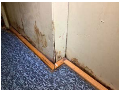
Symptom på fuktskader på toalettrom inntil badet, men det måles tørt på befaringsdagen.
