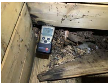
Råteskader på kne loft mot sør, men det måles tørt på befaringsdagen.
