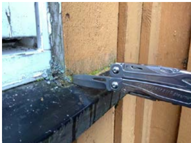
Omramming er ført helt ned til vannbrett, og dette har ført til råteskader.
