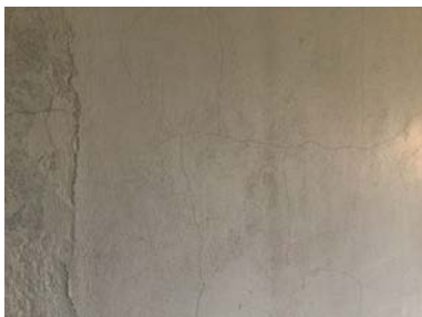
Riss og sprekker i pipe.
