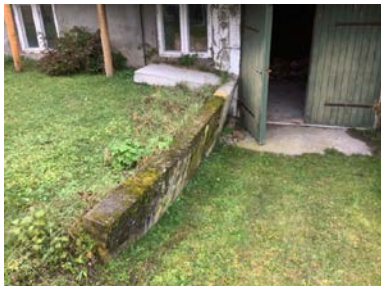
Skjev forstøtningsmur uten rekkverk.
