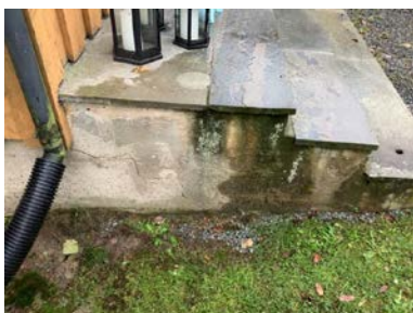
Rekkverk mangler, og det er sprekkdannelse i trapp.
