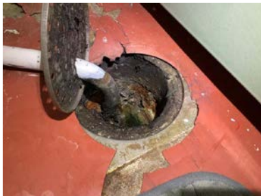
Utett tilslutning mot sluk.
