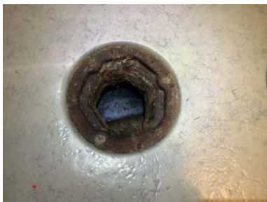
Støpejernsluk, og vinylbelegg er ført under slukets klemring.
