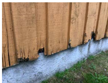
Råteskadet bordkledning på garasje.
