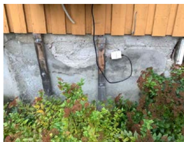
Avskallet betong og sprekkdannelser.
