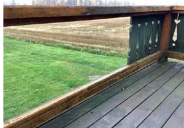
Det mangler flere rekkverksbord.
