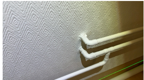
Utettheter i gjennomføring vegg i våtsonen.
