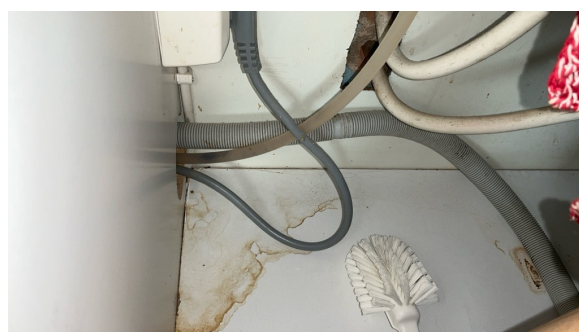
Fuktmerker i underskap under kjøkkenkum.
