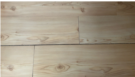
Gulv på kjøkken har sklidd fra hverandre i skjøt.
