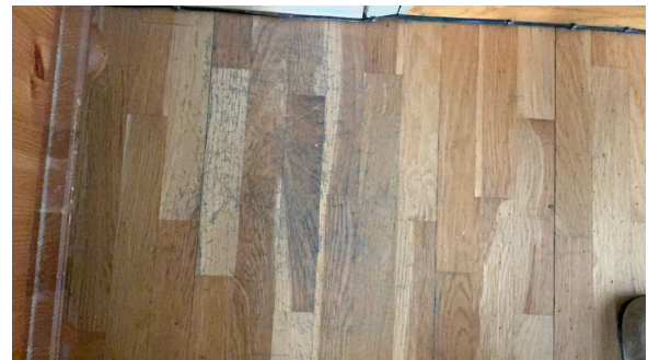
Slitasje på gulv.
