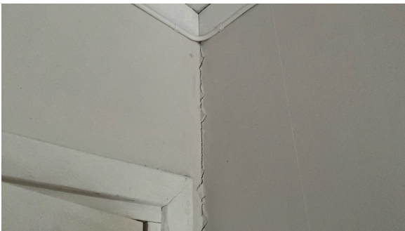
Sprekker i hjørne.
