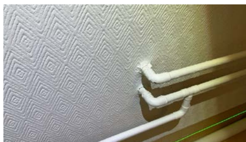
Utettheter i gjennomføring vegg i våtsonen.
