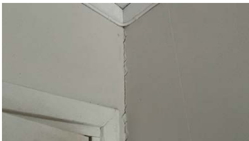
Sprekker i hjørne.
