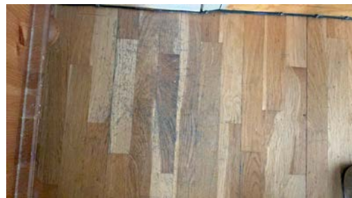
Slitasje på gulv.
