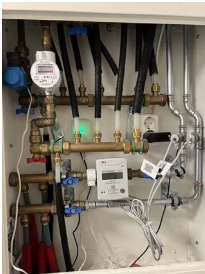
Fordeler skap anlegg til vann båren varme, stoppekran og måler.
