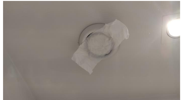
Funksjonstest av avtrekket.
