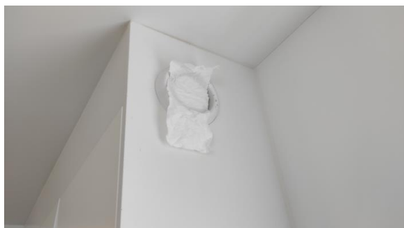
Funksjonstest av avtrekksviften.
