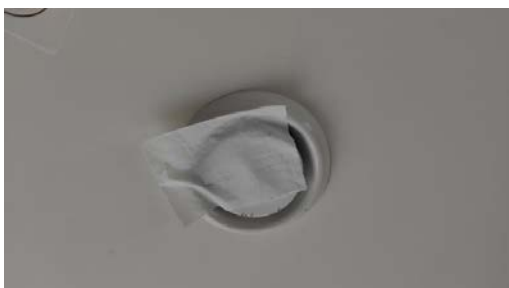
Funksjonstest av avtrekksviften.
