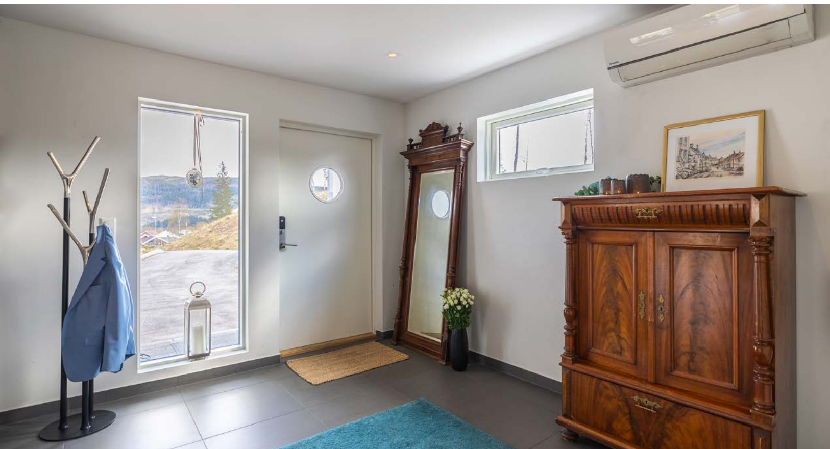
Luft-til-luft varmepumpe av merket Panasonic fra 2014
