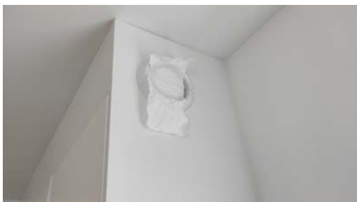
Funksjonstest av avtrekksviften.
