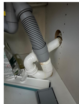
Avløpsrør med motfall i kjøkkenbenk
