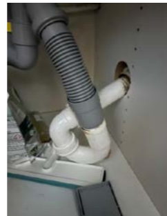
Avløpsrør med motfall i kjøkkenbenk
