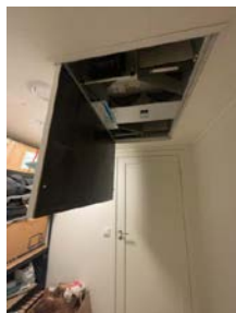
Ventilasjons aggregat plassert i tak i bod.
