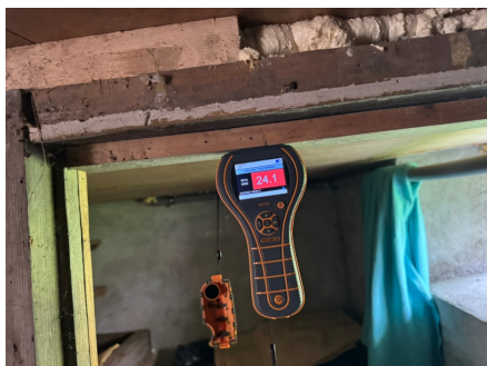
Fuktmåling i kjelleren.
