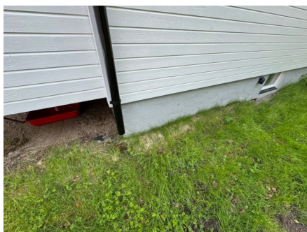
Det er ikke utvendig fuktsikring.
