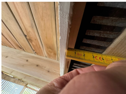
Åpning fra kledningen til musesperren.
