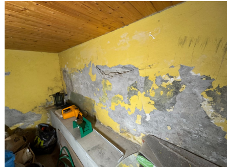
Løs puss på veggen.
