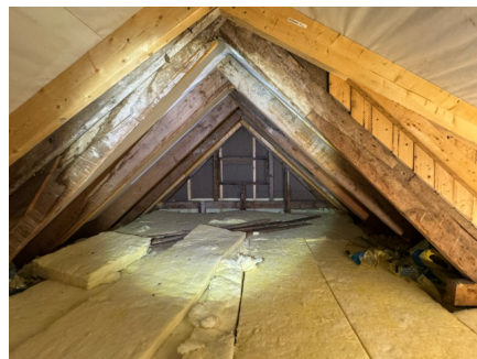
Konstruksjonen er begrenset ventilert.
