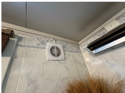
Mekanisk avtrekk på badet.
