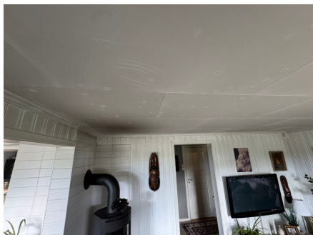
Sotmerker på innvendige overflater.
