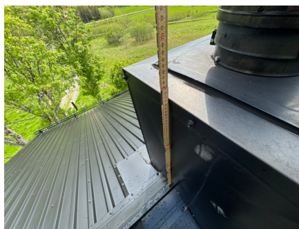
Pipen er ikke høy nokk.
