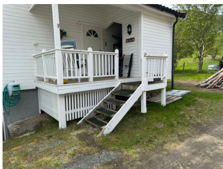
Det er ikke montert rekkverker på trappen.
