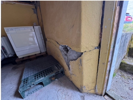
Sprekker i grunnmuren.
