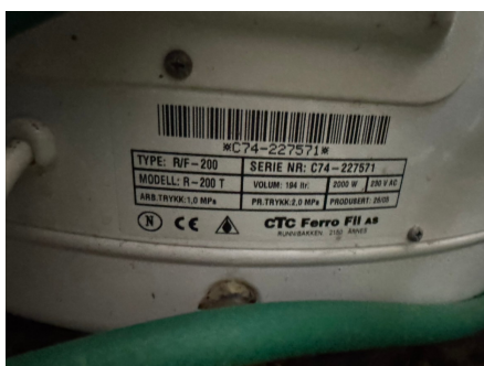
Produksjonsdato på varmtvannstanken.
