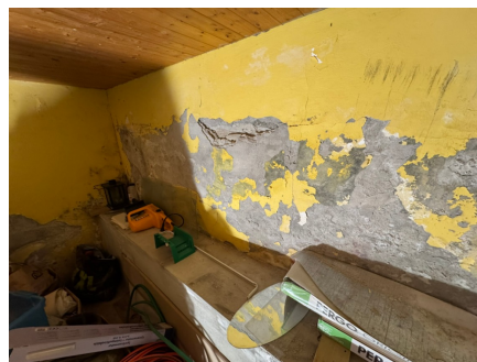
Saltutslag på veggen.
