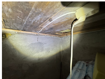
Eksempel på løse ledninger.
