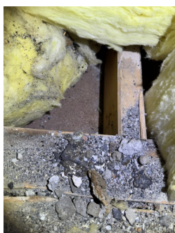
Det er ikke montert dampsperre mellom varm og kald del av konstruksjonen.
