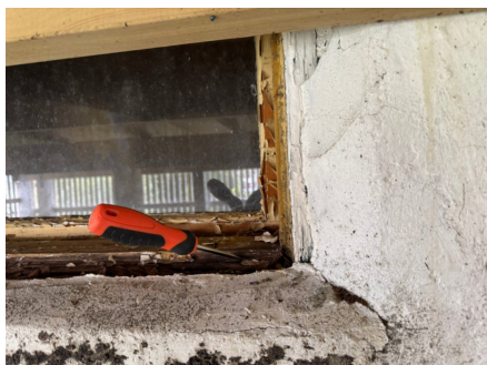
Vindu med råteskade.
