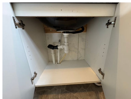
Fuktsvelling i bunnplaten.
