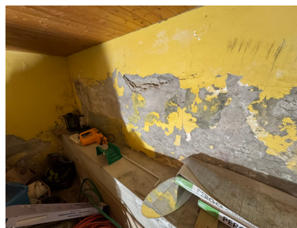
Tegn til at dreneringen ikke er tilstrekkelig.
