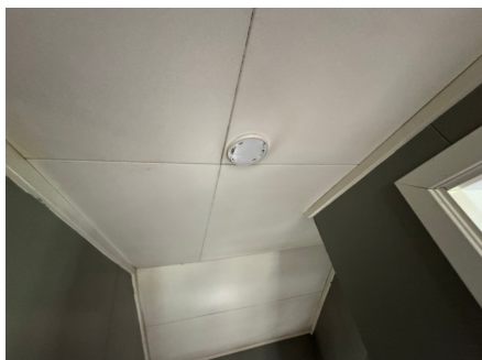
Røykvarsleren er demontert på befæringsdagen.
