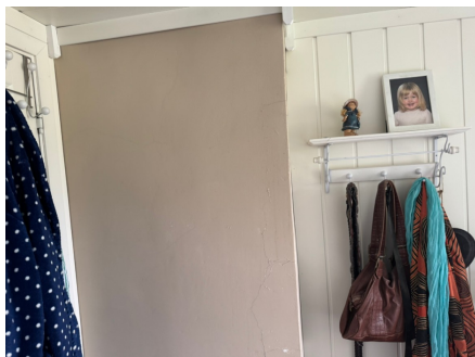
Eksempel på riss i pipen.
