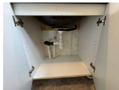
Fuktsvelling i bunnplaten.
