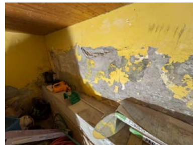
Saltutslag på veggen.
