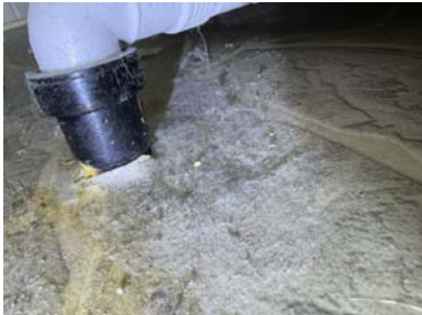
Eksempel på utettheter på vinylbelegget.
