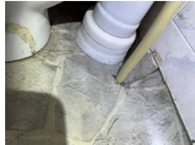
Eksempel på utettheter på vinylbelegget.
