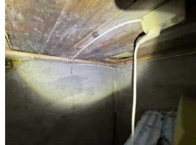
Eksempel på løse ledninger.
