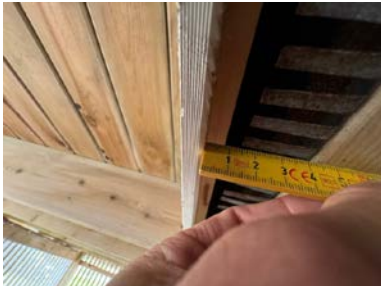
Åpning fra kledningen til musesperren.
