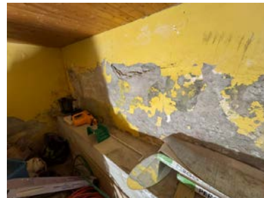
Tegn til at dreneringen ikke er tilstrekkelig.
