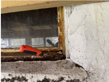
Vindu med råteskade.
