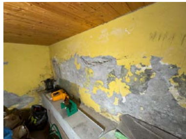
Løs puss på veggen.
