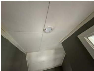
Røykvarslere er demontert på befaringsdagen.
