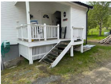
Det er ikke montert rekkverker på trappen.
