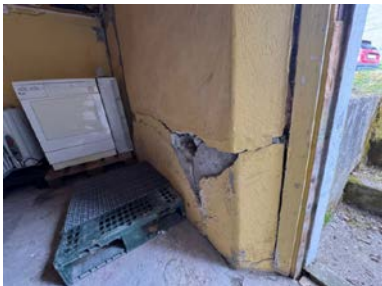
Sprekker i grunnmuren.
