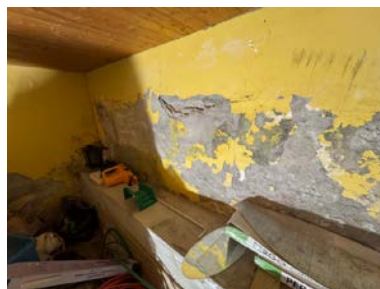
Saltutslag på veggen.
