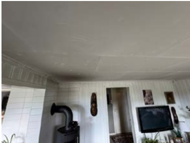
Sotmerker på innvendige overflater.
