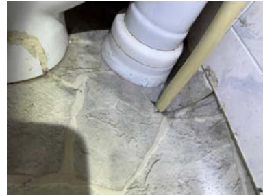
Eksempel på utettheter på vinylbelegget.
