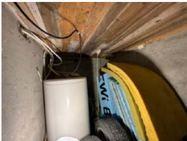
Eksempel på vannrør som ikke er tilstrekkelig festet.
