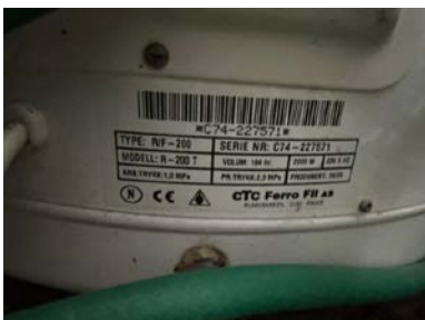
Produksjonsdato på varmtvannstanken.
