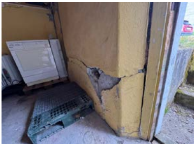
Sprekker i grunnmuren.
