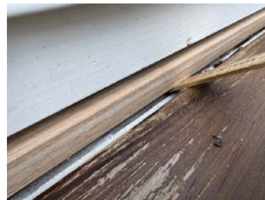
Det er ikke montert beslag under balkongdøren.
