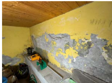
Løs puss på veggen.
