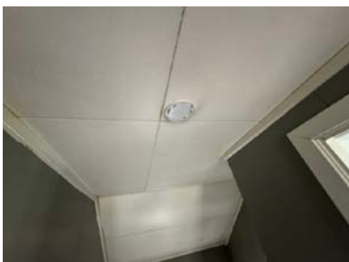
Røykvarslere er demontert på befæringsdagen.
