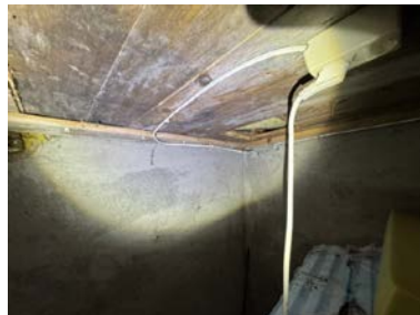
Eksempel på løse ledninger.
