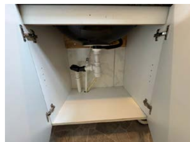
Fuktsvelling i bunnplaten.
