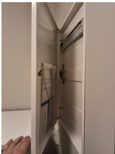
Sikringsskap med automatsikringer er plassert i bod.
