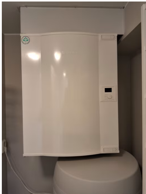
Ventilasjonsaggregat er plassert på bod.
