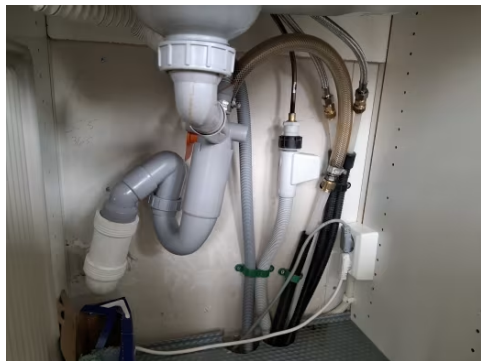
Leiligheten har synlige avløpsrør av plast.
