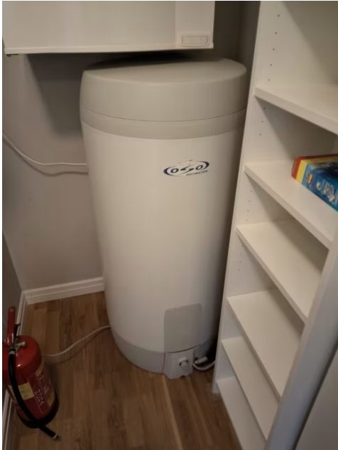
Varmtvannsbereder er plassert i bod.
