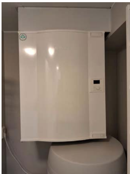
Ventilasjonsaggregat er plassert på bod.
