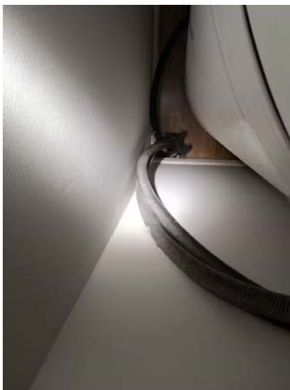
Leiligheten har vannrør av rør-i-rør.
