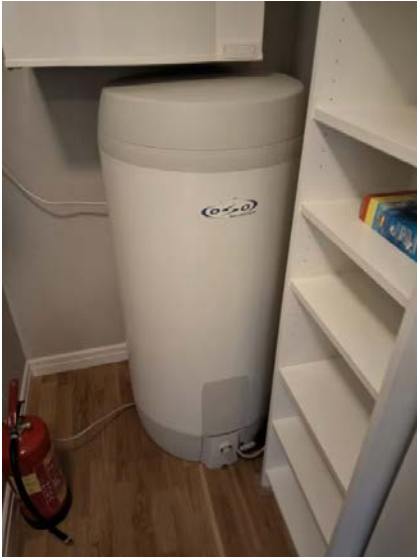
Varmtvannsbereder er plassert i bod.
