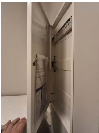
Sikringsskap med automatsikringer er plassert i bod.
