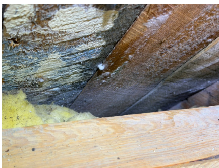
Det er påvist rim på undertaket.
