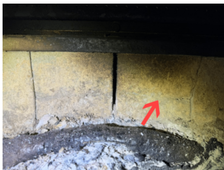
Skadet stein i vedovnen.
