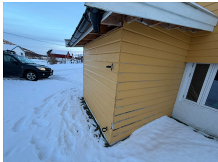
Takrennen mangler nedløp.
