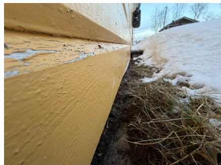
Eksempel på liten avstand mellom kledning og terreng.
