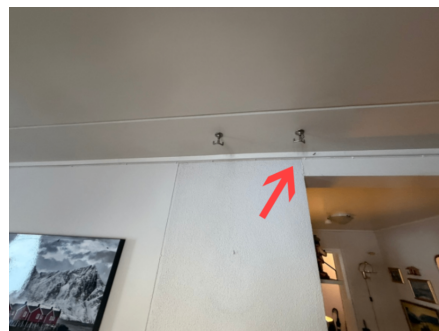
Avstand til brennbart materiale er ikke ivarettatt.
