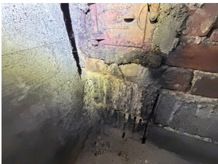
Sotluken lot seg ikke åpne på befaringstidspunktet.
