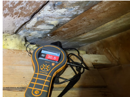
Fuktmåling i undertak.
