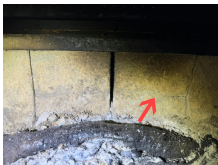
Skadet stein i vedovnen.
