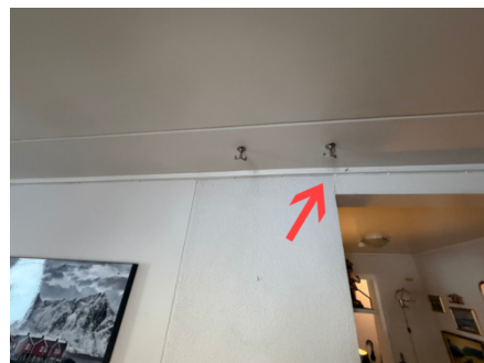
Avstand til brennbart materiale er ikke ivarettatt.
