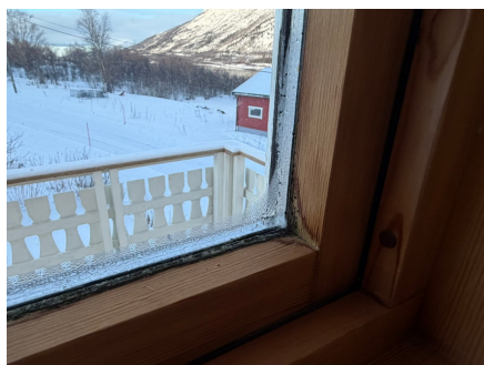
Eksempel på kondensering på innvendig vindusglass.
