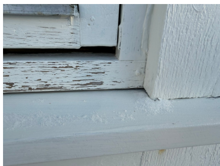
Eksempel på værslitt overflatebehandling og omramming som støter mot beslaget.
