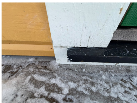
Eksempel på omramming som støter mot vannbrettbeslag.
