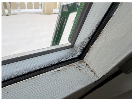
Kondensering på innvendig glass.
