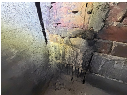
Sotluken lot seg ikke åpne på befaringsstidspunktet.
