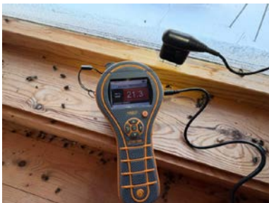
Fuktmåling i vindu kaldloft.
