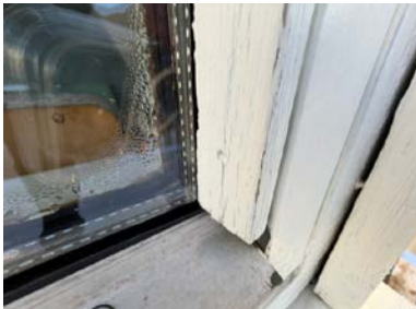
Eksempel på værslitte lister utvendig og kondensering på innvendige glassflater.
