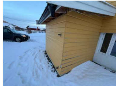
Takrennen mangler nedløp.
