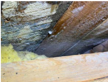
Det er påvist rim på underteaket.
