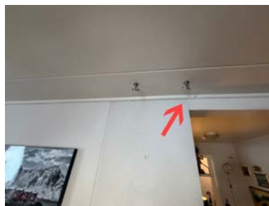
Avstand til brennbart materiale er ikke ivaretatt.
