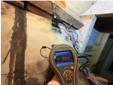
Fuktmåling ved pipe.
