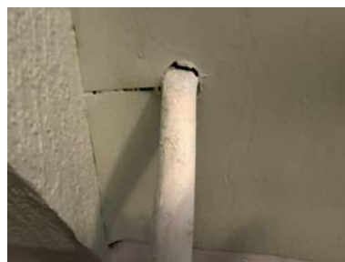
Utett gjennomføring i vegg.
