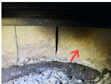
Skadet stein i vedovnen.
