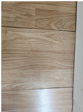
Overflater har en del slitasjegrad utover det en kan forvente.
