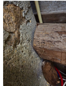
Det mangler søyler under bærende bjelker.
