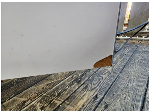
Skade på hovedytterdør.
