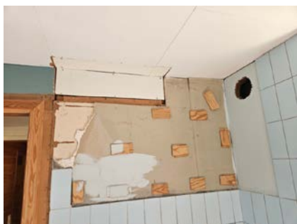
Overflater har en del slitasjegrad utover det en kan forvente.
