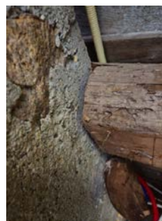
Det mangler søyler under bærende bjelker.
