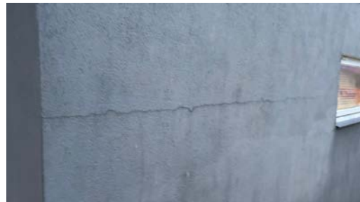
Det er noen riss/sprekker på garasjedelen
