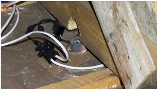
Dampsperre brutt ved installering av spotter i himlingen i 1. etasje
