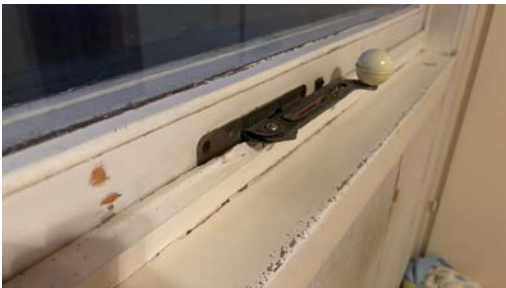
Vinduet på det ene soverommet er slitt
