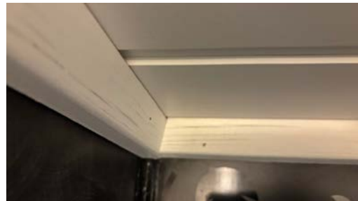
Fuktmerker på overflaten til listverk i dusjnisen
