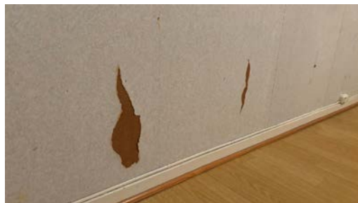
Overflatene på det ene soverommet lengst sørøst fremstår nedslitt
