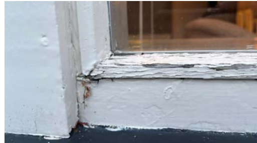
Vinduene av eldre årgang er værslitt utvendig
