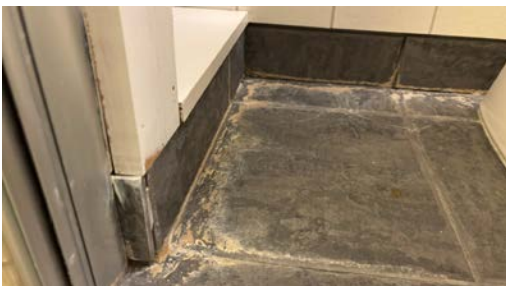
Fuktmerker på gulvet mellom toalettet og dusjnisen
