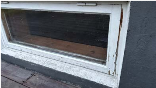
Vinduene av eldre årgang er værslitt utvendig
