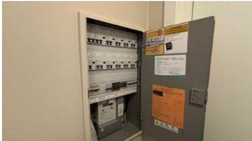
Sikringsskapet er plassert i entreen
