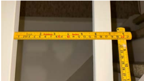
Åpninger i rekkverket på 15 cm
