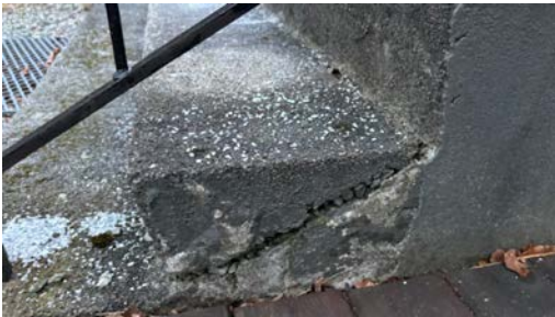
Mindre sprekker og skader på overflaten
