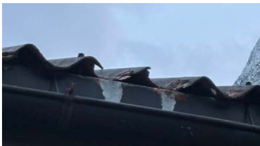
Eternittaket har mindre skader enkelte steder
