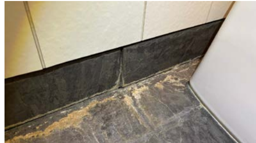
Sokkelflisene ved toalettet er løse
