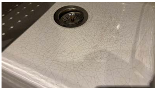
Det er sprekke dannelse/krakelering i vasken
