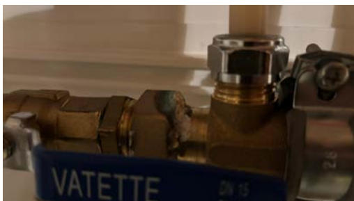
Det er noe irr på en kobling i fordelerskapet
