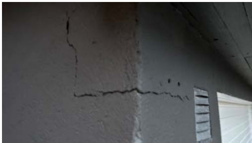
Det er noen riss/sprekker på garasjedelen
