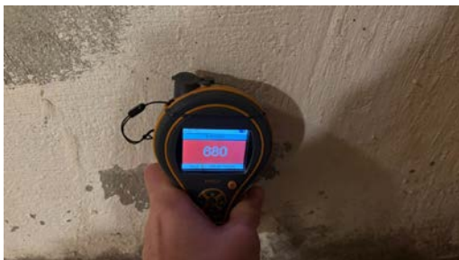
Utslag på forhøyde fuktverdier på ytterveggene i kjelleren
