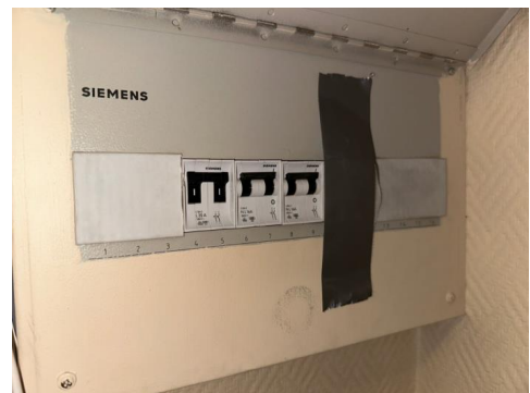
Sikringskap med automatsikringer.
