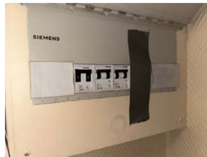
Sikringsskap med automatsikringer.
