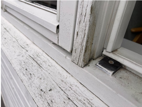
Råtskader i nedre del av vindu.
