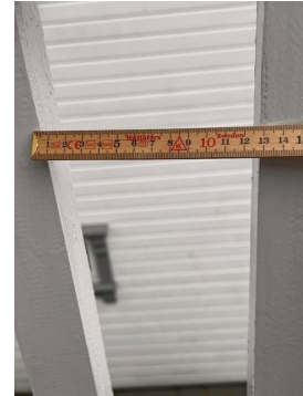
Rekkverk stolper med større avstand enn 100 mm
