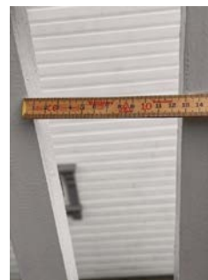
Rekkverk stolper med større avstand enn 100 mm
