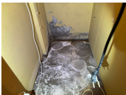
Fuktgjennomtrenging i gulv og vegg.
