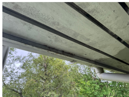
Eksempel på tegn til lekkasje på taket.
