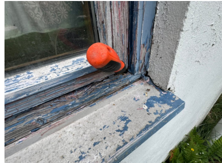
Vindu med råteskade.
