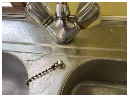
Det drypper av kranen på kjøkkenet.
