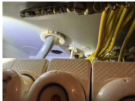
pning i sikringsskapet.
