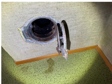
Det er ikke ildfast plate under sotluken.
