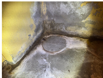
Synlig fuktighet i underetasjen.
