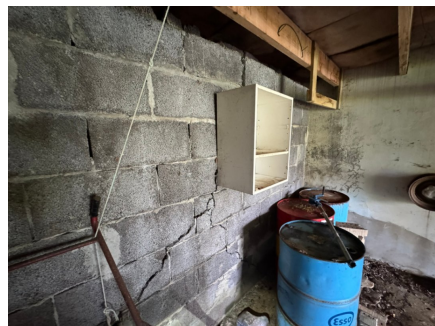
Store sprekker i muren i garasjen.
