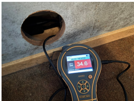
Hulltaking tatt på soverommet hvor det er svertesopp på vegg.
