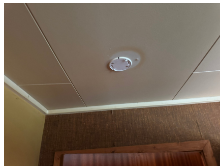
Røykvarsleren er demontert.
