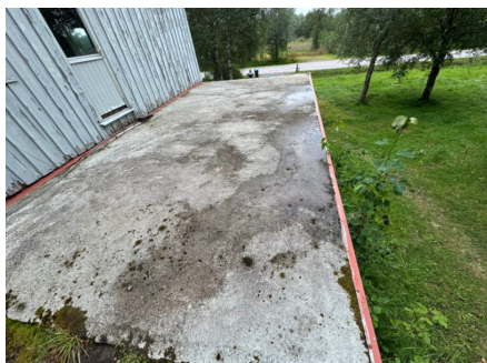
Det er ikke rekkverk eller tettesjikt på dekket.
