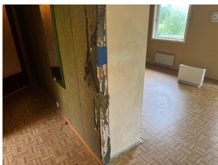
Eksempel på skader på innvendige overflater.
