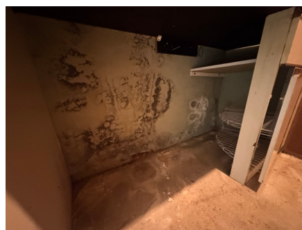
Fuktgjennomtrenging på vegg.
