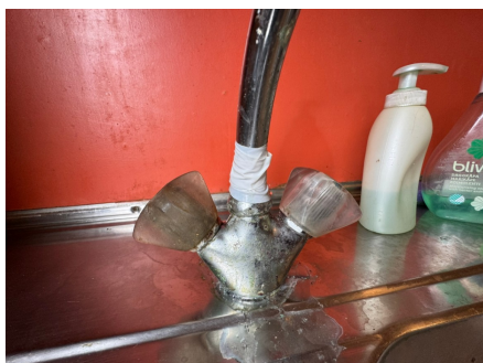
Kran som lekket og er tapet fast
