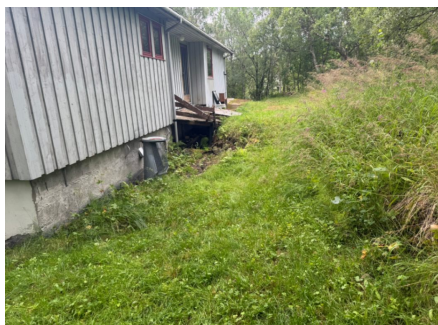
Terrenget har fall inn mot boligen.
