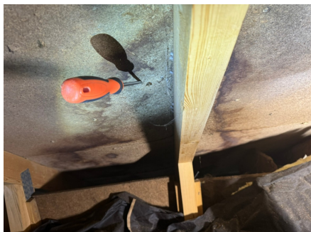
Fukt/ råteskader i taktro.
