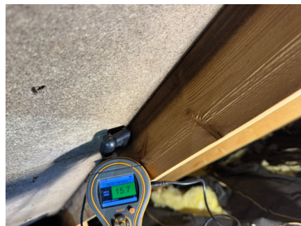
Fuktmåling ved fukt/råteskade.
