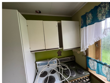
Døren til overskapet har feil størrelse.
