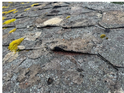
Skader på taktekingen.
