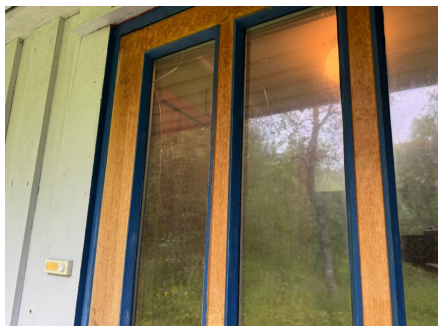
Sprekker i glasset på døren.
