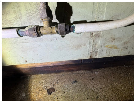
Drypping fra vannrør.
