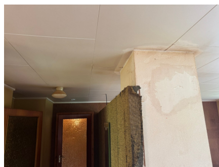
Fuktskader rundt pipen.
