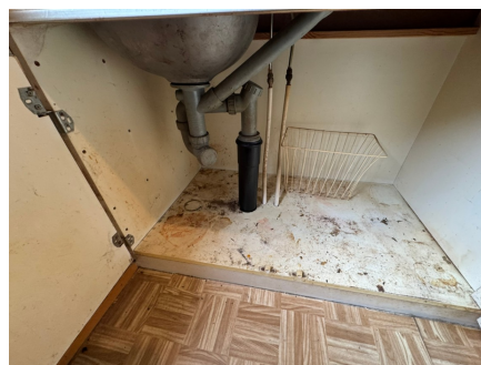
Skader i benkeskap.
