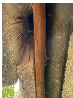
Det er ikke montert musesperre bak kledningen.
