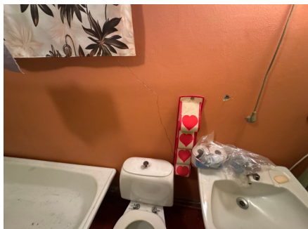
Sprekk i grunnmuren på badet.
