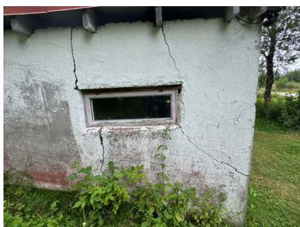
Sprekker i muren ved garasjen.
