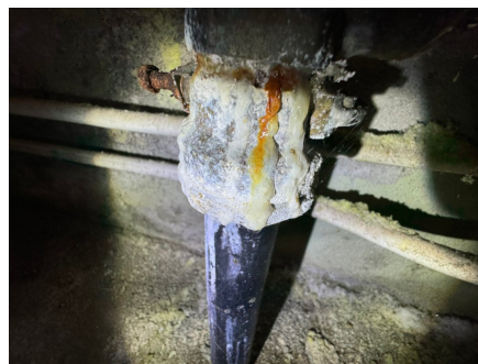
Drypping fra vannrør ved vanninntaket.
