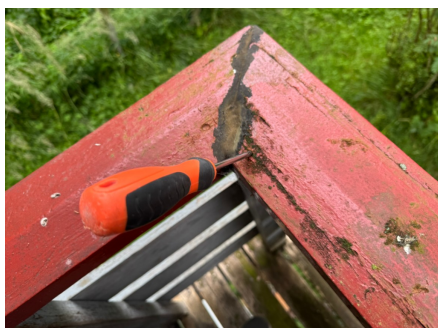
Råteskade i rekkverk.
