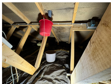
Bøtte under takventilen.
