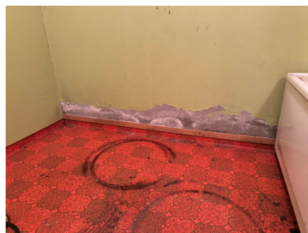
Fuktskader på vegg.
