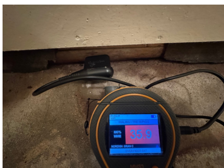
Fuktmåling i svill fra boden.
