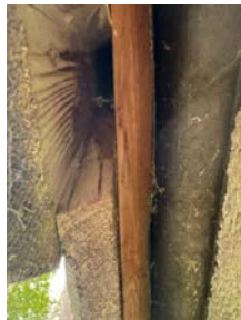
Det er ikke montert musesperre bak kledningen.
