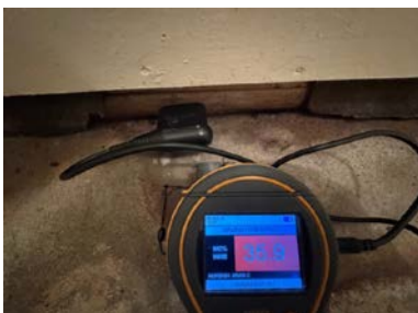
Fuktmåling i svill fra boden.
