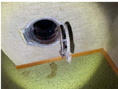
Det er ikke ildfast plate under sotluken.
