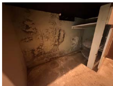
Fuktgjennomtrenging på vegg.
