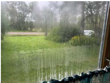
Eksempel på punkttert vindu.
