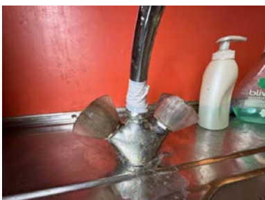
Kran som lekket og er tapet fast
