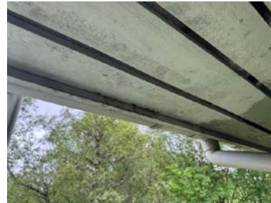
Eksempel på tegn til lekkasje på taket.
