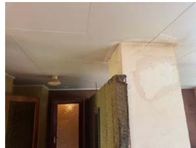
Fuktskader rundt pipen.
