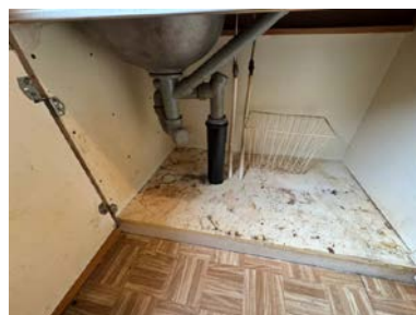
Skader i benkeskap.
