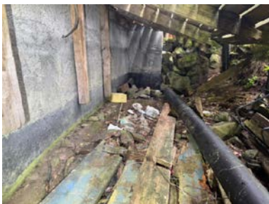
Utvendig fuksikring er trekulltjære
