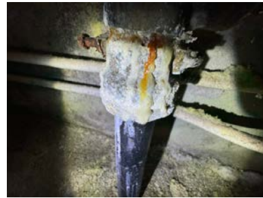
Drypping fra vannrør ved vanninntaket.
