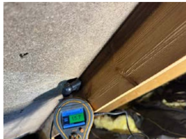
Fuktmåling ved fukt/råteskade.
