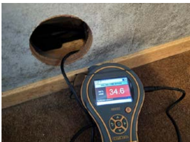
Hulltaking tatt på soverommet hvor det er svertesopp på veggen.
