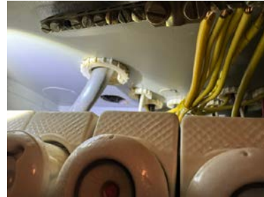
pnning i sikringsskapet.
