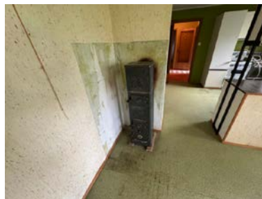
Det er ikke ildfast plate under ildstedet i underetasjen..
