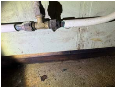
Drypping fra vannrør.
