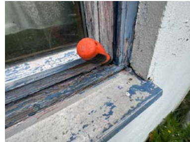
Vindu med råteskade.
