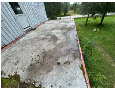
Det er ikke rekkverk eller tettesjikt på dekket.
