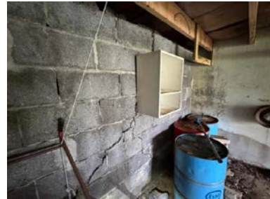
Store sprekker i muren i garasjen.
