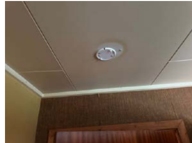
Røykvarsleren er demontert.
