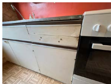
Skader og manglende håndtak.
