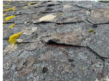
Skader på taktekingen.
