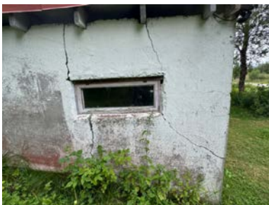
Sprekker i muren ved garasjen.
