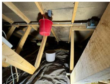
Bøtte under takventilen.
