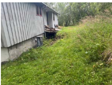
Terrengtet har fallt inn mot boligen.
