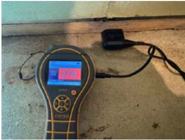
Fuktmåling i svill mot vaskerommet.
