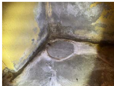
Synlig fuktighet i underetasjen.
