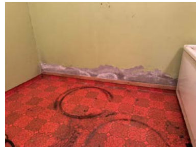
Fuktskader på vegg.
