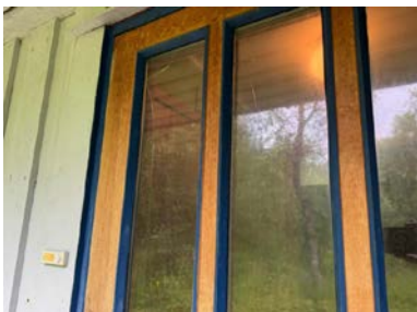
Sprekker i glasset på døren.
