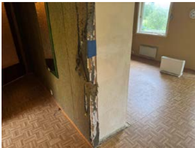
Eksempel på skader på innvendige overflater.
