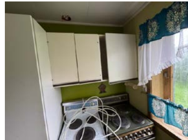
Døren til overskapet har feil størrelse.
