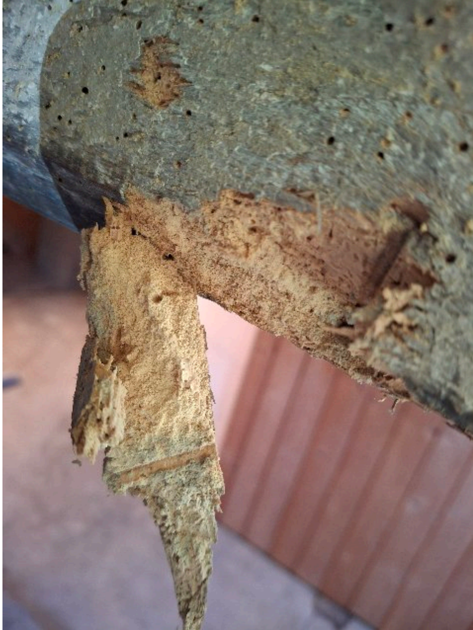
Skade på bjelke
