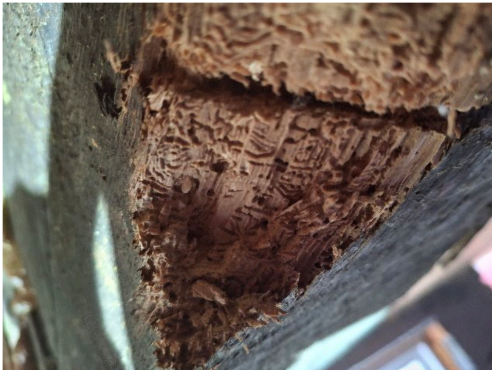
Skade av borebille
