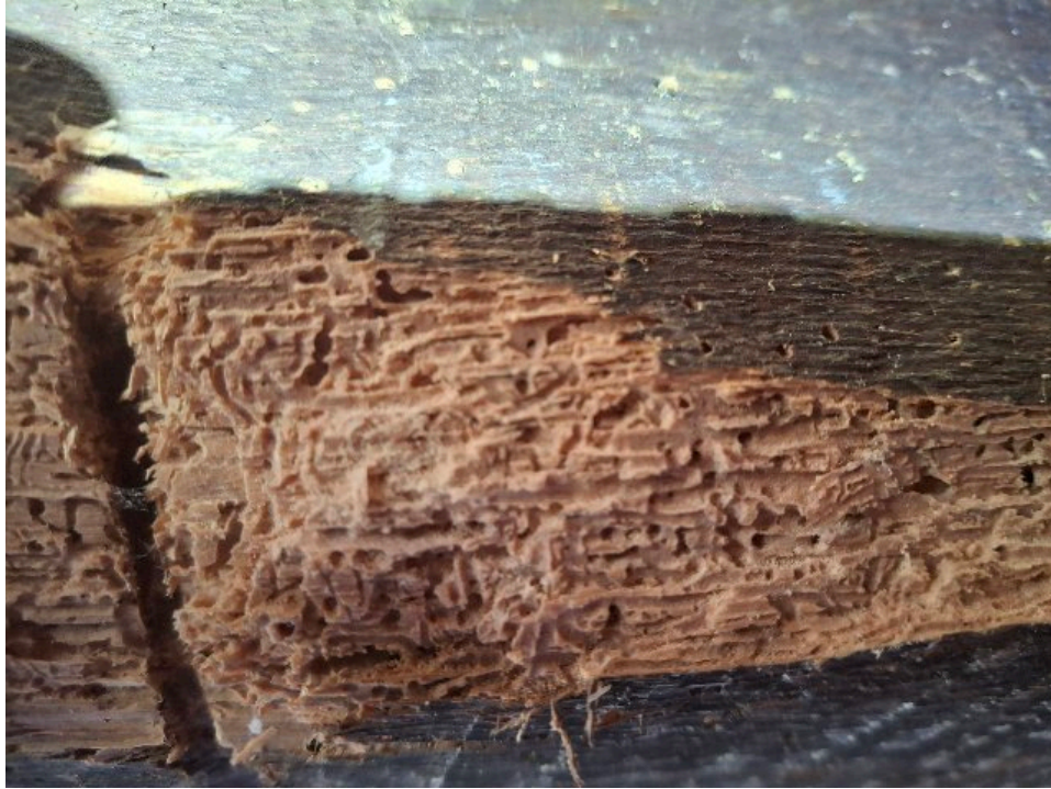
Skade av borebille
