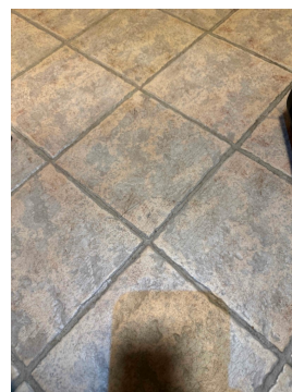
Bildet viser sprekk i gulvflis i gangen.
