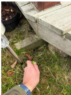
Bildet viser treverk i kontakt med terreng.
