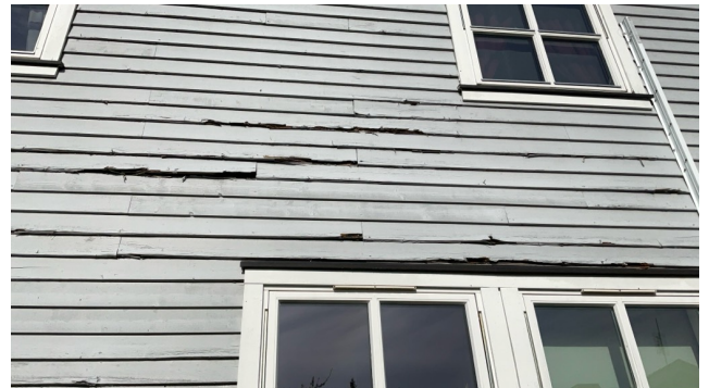
Råte på panel.
