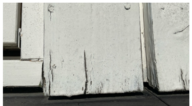
Råteskader utvendig omramming.
