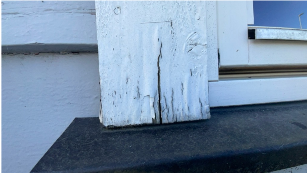
Råteskader utvendig omramming.
