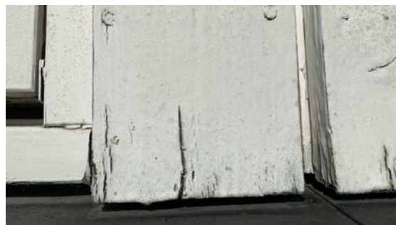
Råteskader utvendig omramming.
