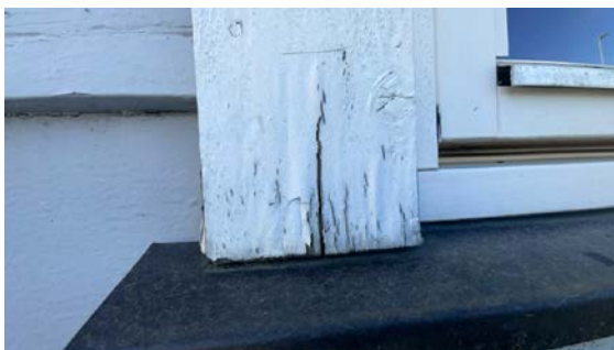
Råteskader utvendig omramming.
