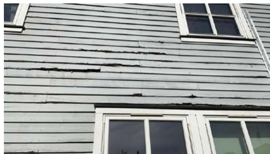
Råte på panel.
