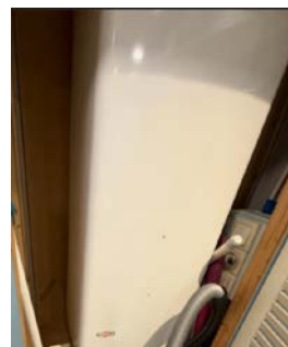
Bereder i skap på bad av eldre ukjent dato
