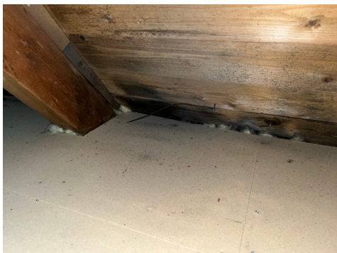
Misfarging i undertak.
