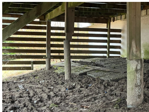
Skjevhet i søyler.
