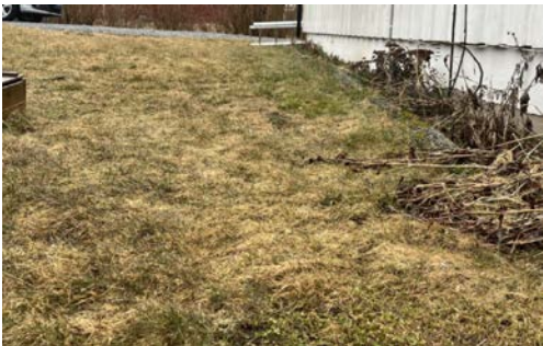
Terreng faller mot boligen
