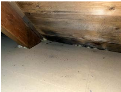
Misfarging i undertak.
