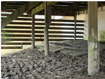
Skjevhet i søyler.
