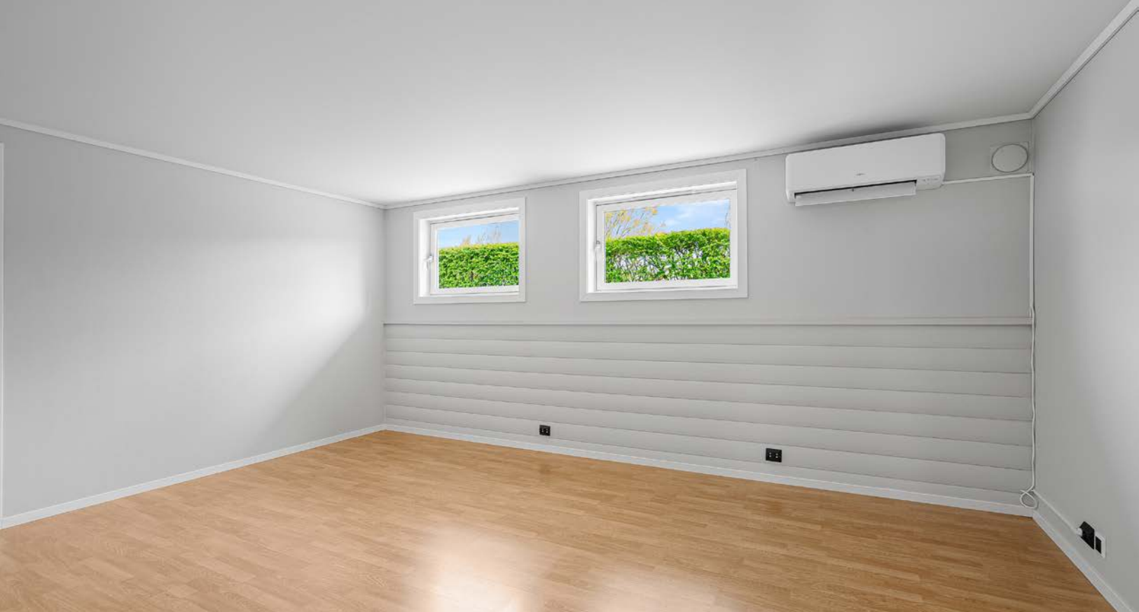
Kjellerstue ( ikke godkjent) har ny varmepumpe
