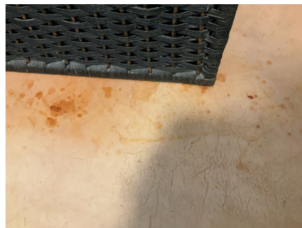
Merker på gulvbelegget.
