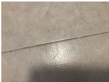
Sprekk i membran, våtrommet er utett.
