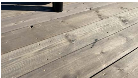
Generelt skrukehull som ikke er skruer i og trolig gjennbrukte materialer fra tidligere innfesting
