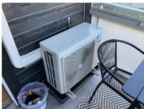
Utvendig del varmpumpe.
