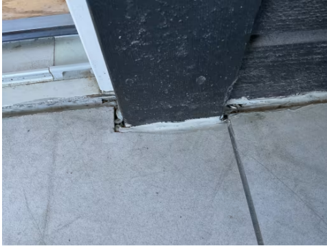
Ufagmessig utførelse på fuger mot vegger.
