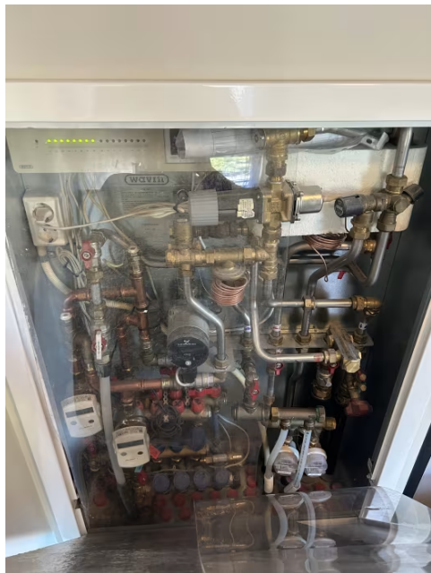
Fordelerskap for vann og vannbårenvarme
