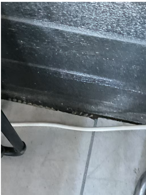
Ufagmessig utførelse på fuger mot vegger.
