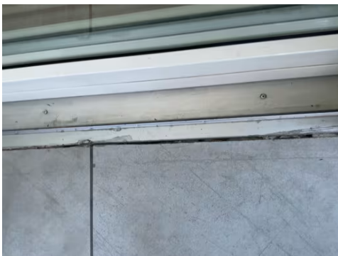
Ufagmessig utførelse på fuger mot vegger.
