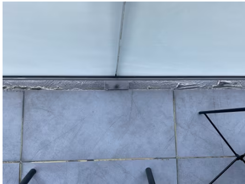
Ufagmessig utførelse på flisarbeid.
