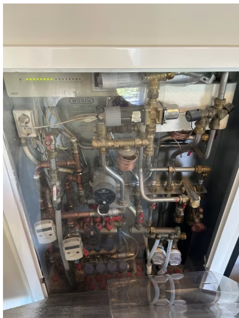
Fordelerskap for vann og vannbåren varme.
