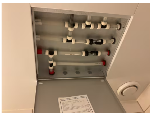
Fordelerskap i tak på badet.
