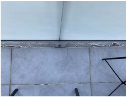
Ufagmessig utførelse på flisarbeid.
