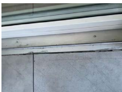
Ufagmessig utførelse på fuger mot vegger.
