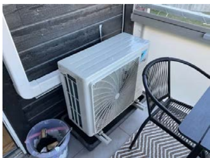
Utvendig del varmpumpe.
