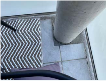
Ufagmessig utførelse på flisarbeid.
