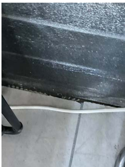
Ufagmessig utførelse på fuger mot vegger.
