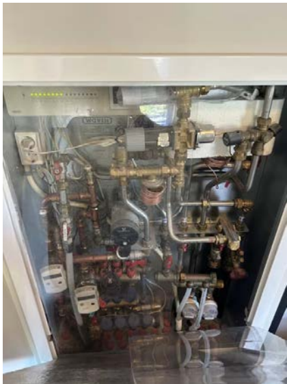
Fordelerskap for vann og vannbårenvarme
