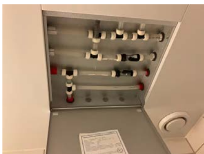
Fordelerskap i tak på badet.
