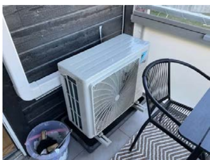
Utvendig del varmpumpe.
