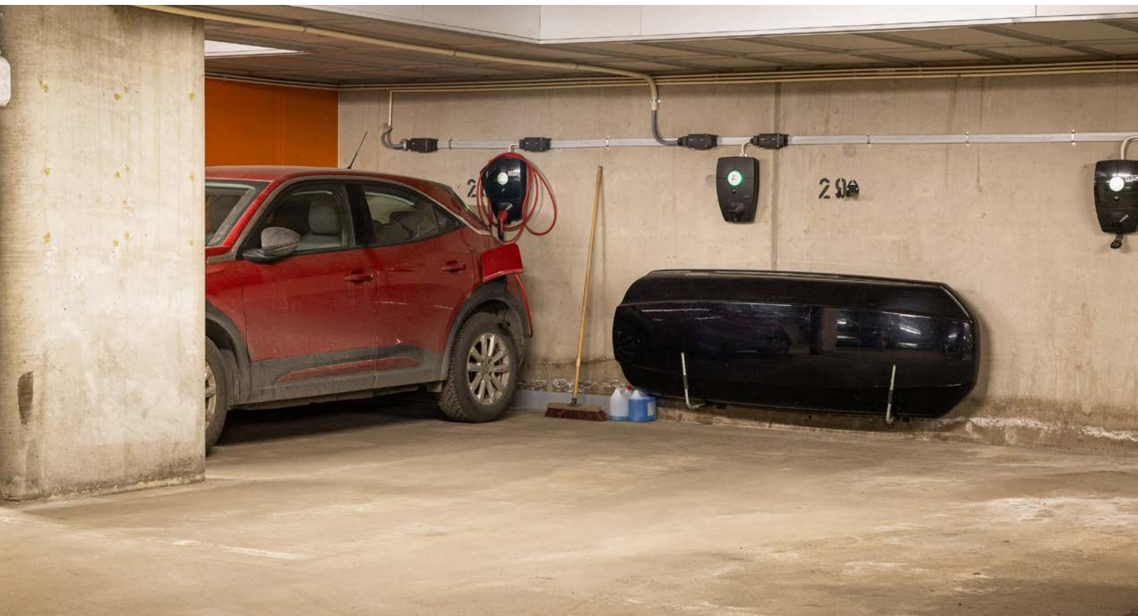
Boligen disponerer egen garasje plass i felles, lukket anlegg. Oppheng for skiboks. Plassen er utstyrt med appstyrt elbil-lader fra Zaptec Pro.
