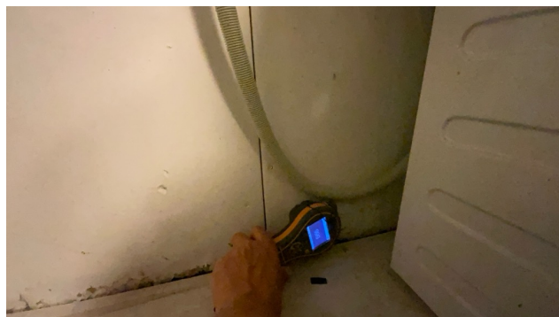
Fullt utslag med fuktindikator i bunn av vegg.
