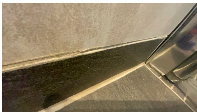
Ikke synlig aluminiumslist i bunn av veggplater.
