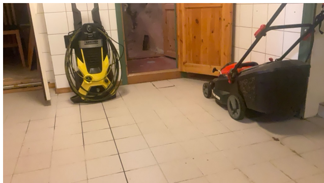
Enkelte løse fliser på gulv.
