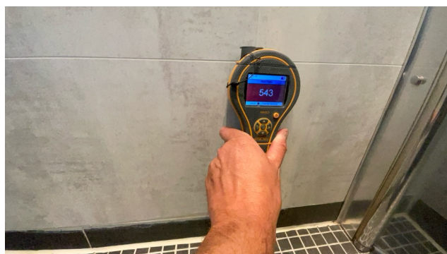
Indikasjoner på fukt i veggplate.
