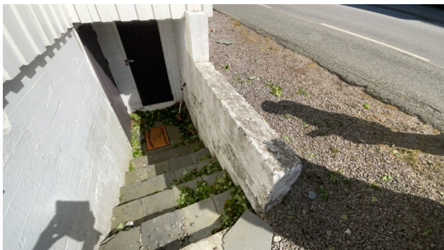
Vange til kjellertrapp er ikke sikret med rekkverk.
