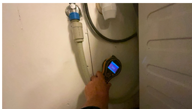
Fult utslag med fuktindikator, målt ca 0,5 meter opp på vegg fra gulv.
