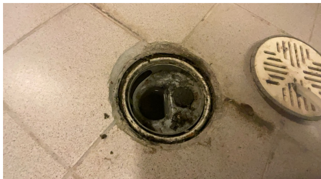
Sluk i gulv, uten synlig membran.
