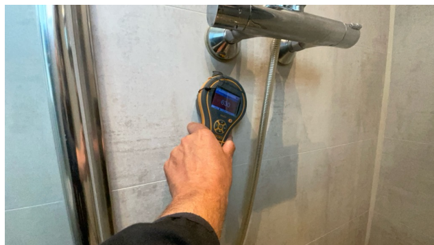
Indikasjoner på fukt i veggplate under blandebatteri.
