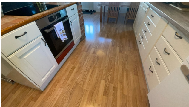
Skjevt gulv i kjøkken i 1.etasje.
