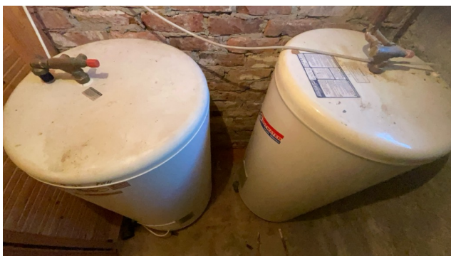
Eldre varmtvannstanker, montert i bod i kjeller.
