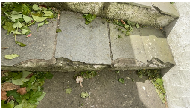
Skader i fliser på kant av trinn til kjellertrapp.
