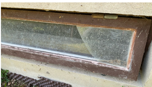
Sprekk i 1 vindusglass.
