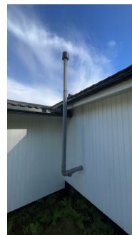
Lufting til Cinderella forbrenningstolett montert på yttervegg.
