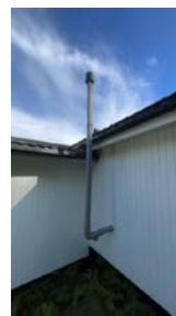
Lufting til Cinderella forbrenningstoalett montert på yttervegg.
