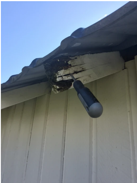
Råteskader i taksperrer.
