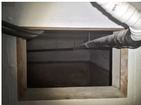
Synlige avløpsrør av plast.
