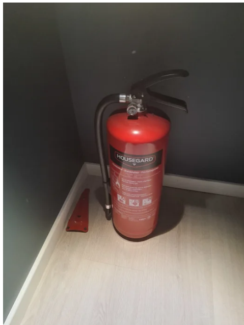
Brannslukningsapparat plassert i soverom.
