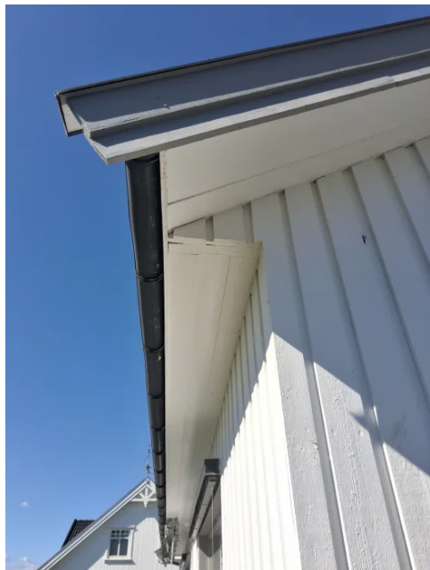
Det registreres ingen lufteåpninger i gessimskasser/takraft.
