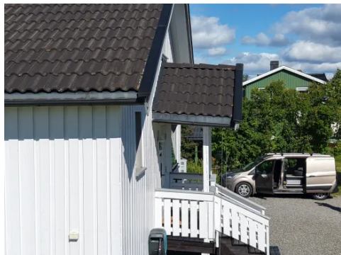
Inngangspartiet har tydelige skjevhet.
