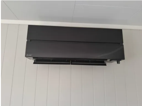
Varmepumpe er plassert i stue.
