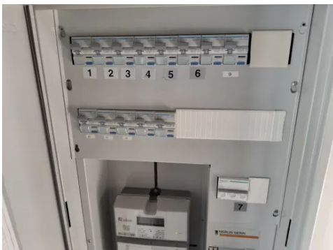
Sikringsskap er plassert i trappegang.
