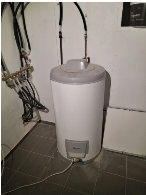
Varmtvannsbereder er plassert i kjøllergang.
