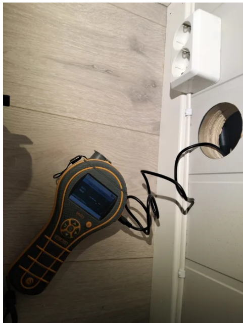
Bilde fra fuktmåling i veggkonstruksjon tilstøtende våtsone.
