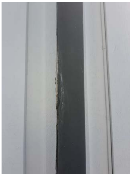
Det registreres buling på taknedløp.
