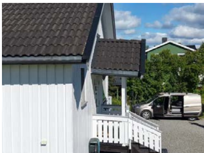
Inngangspartiet har tydelige skjevhet.
