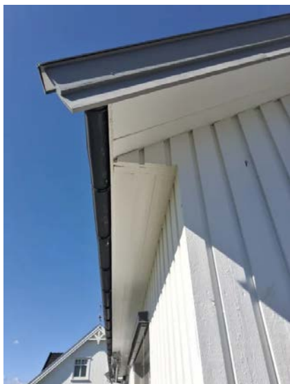
Det registreres ingen lufteåpninger i gessimskasser/takraft.
