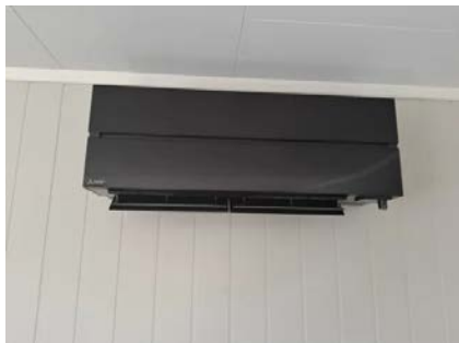
Varmepumpe er plassert i stue.
