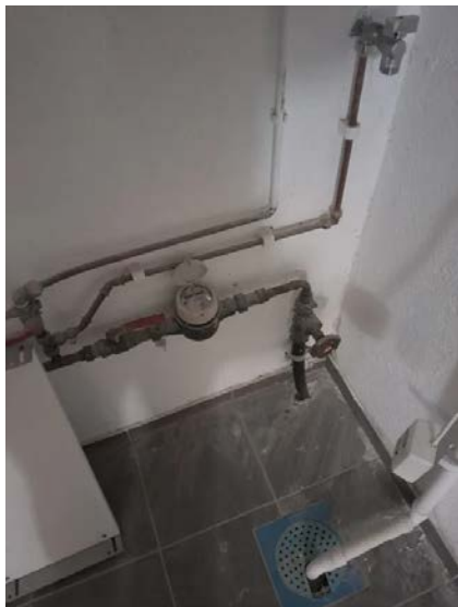
Hovedstoppekran er plassert i kjellergang.
