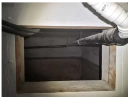
Synlige avløpsrør av plast.
