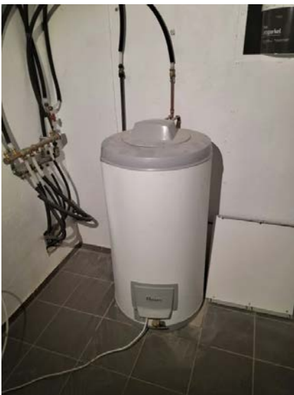
Varmtvannsbereder er plassert i kjellergang.
