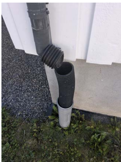
Drensrør av knekt og vann fra nedløpsrør blir ikke ført ned i drensrør.
