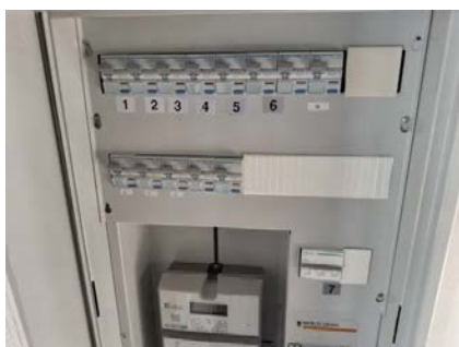
Sikringsskap er plassert i trappegang.
