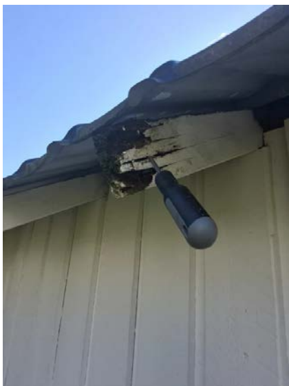
Råteskader i taksperrer.
