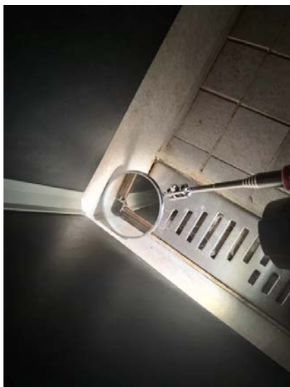
Baderomsplater er montert uten bruk av sokkellist, og det registreres ingen bruk av tettemasse i skjøter/hjørner.
