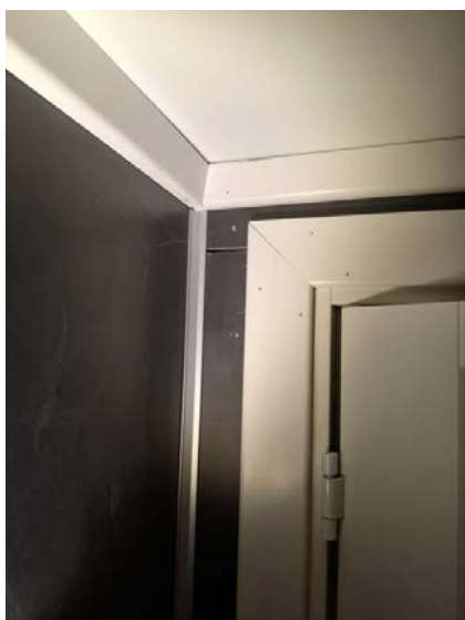
Montering av baderomsplater bærer ikke preg av fagmessig god utførelse.
