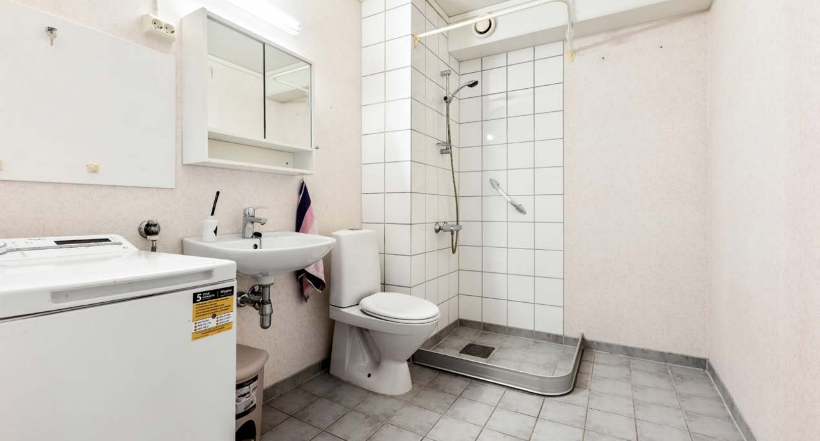
Eldre baderom med behov for oppgraderinger. Badet inneholder servant, speilskap, toalett og dusjhjørne med hånddusj.
