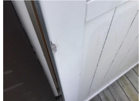
merke på balkongdør 2 etg.
