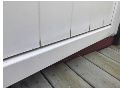
fuktskade på balkongdør 2 etg.
