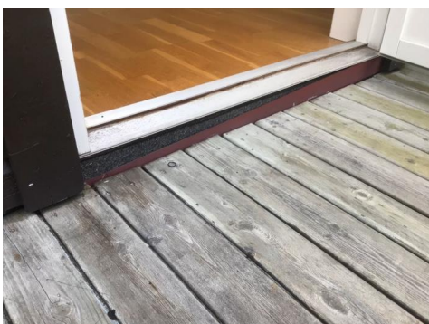
løst beslag under balkongdør 2 etg.
